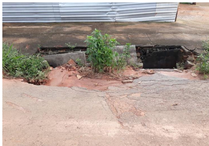
Figura 13 – Deterioração da rede coletora de Água
