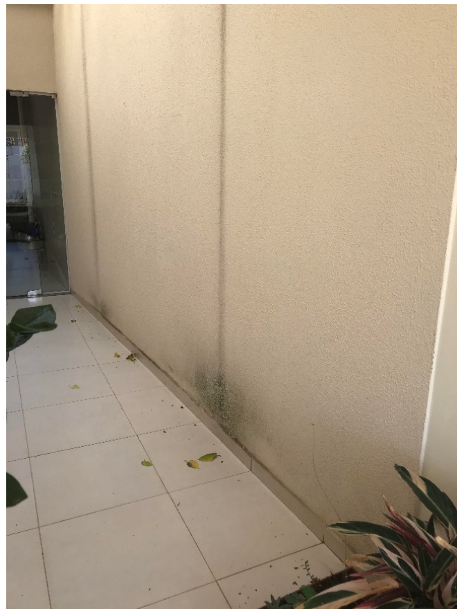
Figura 14: Mofo parede residência.
