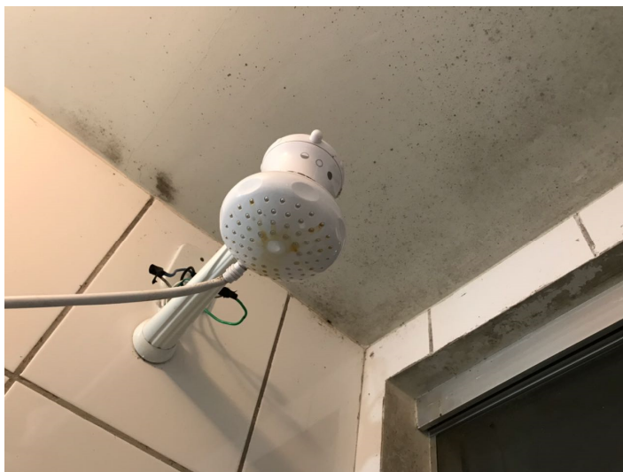
Figura 17: Patologia no teto do banheiro.
