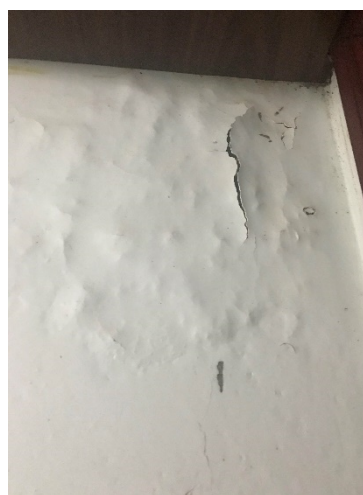
Figura 16: Trincas na pintura.
