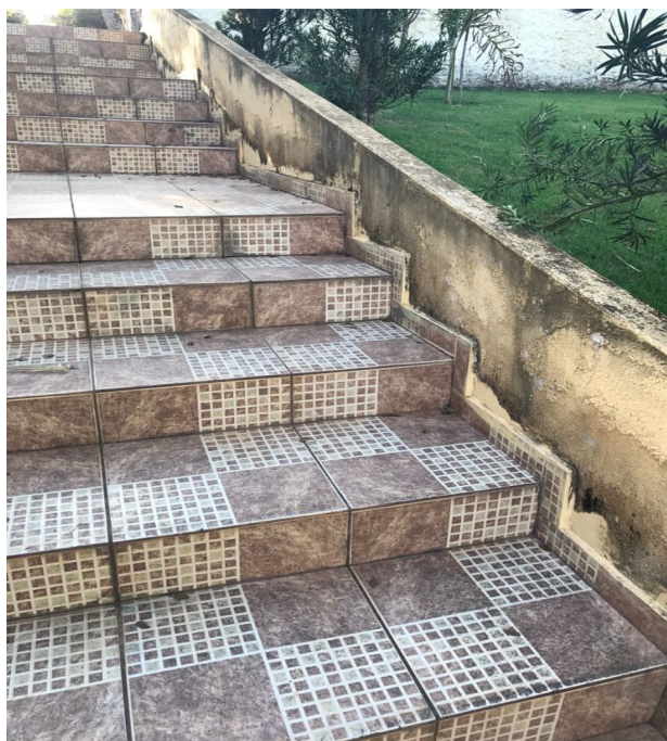
Figura 29: Parede danificada chácara.
