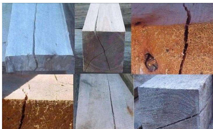
Figura 2.4 – Rachadura na madeira.
