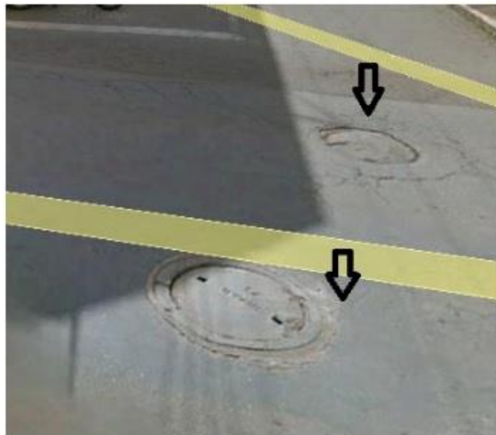
Figura 26 – Poço de vista de esgoto que segundo os moradores rompe em cenários de alagamentos
