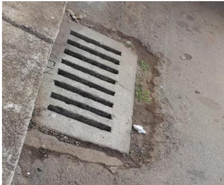
Figura 42 – Boca coletora com tampa de concreto
