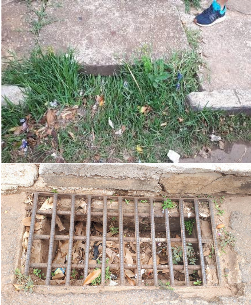
Figura 30 – Bocas coletoras sem manutenção periódica no local em estudo
