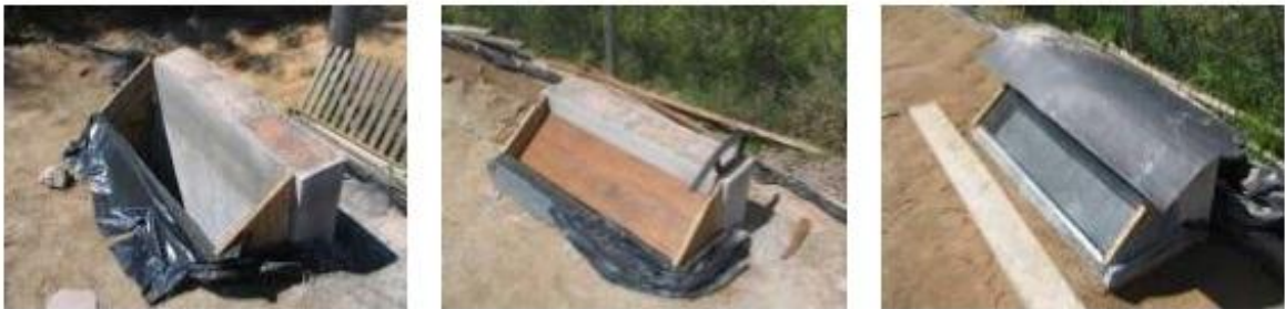
Foto 5 – chaminé de captação de vento
