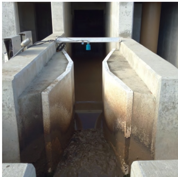
Figura 4– Calha de Parshall com medidor ultrassônico.
