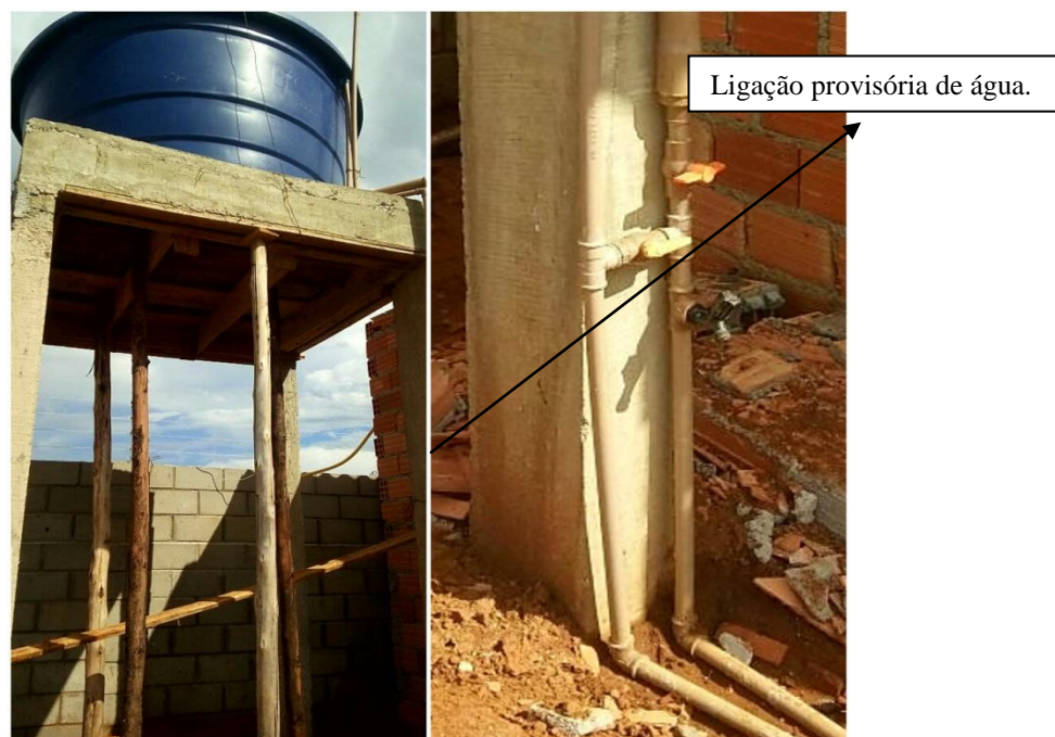
Figura 11 - Rede provisória de água do canteiro da obra 2.
