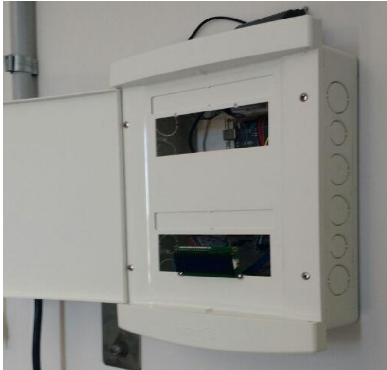
Figura26: Caixa de distribuição.
