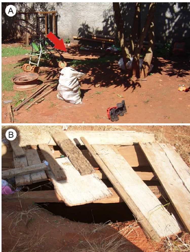
Figura 22. Fossas rudimentares de residências no Conjunto Filostro Machado. A – Fossa sem sistema de escoamento coberta. B – Fossa sem escoamento, desprotegida e em local de risco. Foto registrada por William Alves de Abreu, colaborador da pesquisa, março, 2011.
