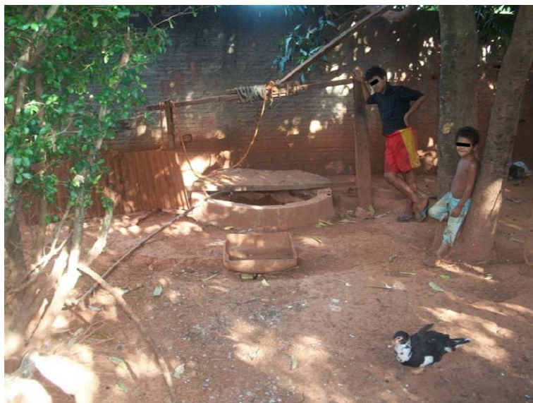
Figura 18. Cisterna domiciliar destampada e sem condição de saneamento para o consumo humano, Conjunto Filostro Machado, Anápolis, 2010. Foto registrada pelo autor.
