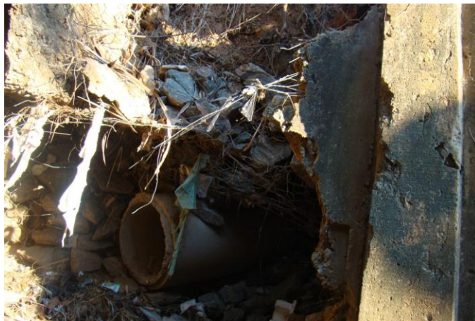
Figura 8:TUBULAÇÃO NO PONTO DE AMORTECIMENTO
