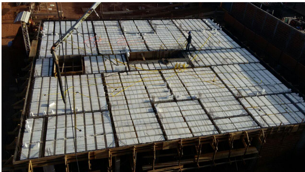
Figura 14 - Instalações de energia, tubulações de água e esgoto
