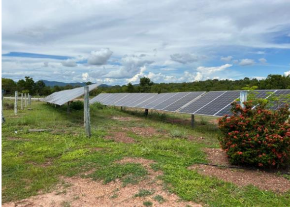
Fotografia 24: placas fotovoltaicas EFAU
