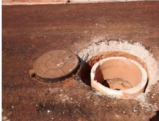
Figura 45 – Poço de visita para rede de drenagem
