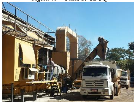
Figura 48 – Usina de CBUQ
