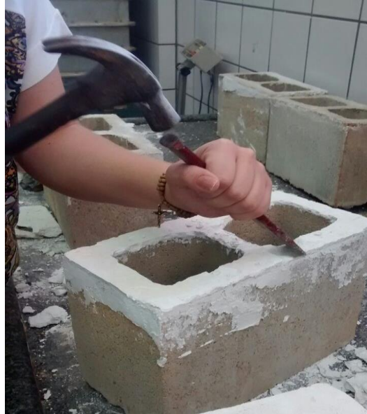
Figura 20 – Quebra do capeamento de gesso
