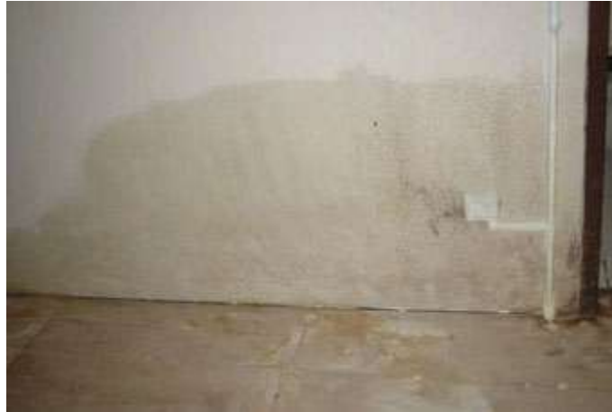
Figura 02 - Manchas na parede
