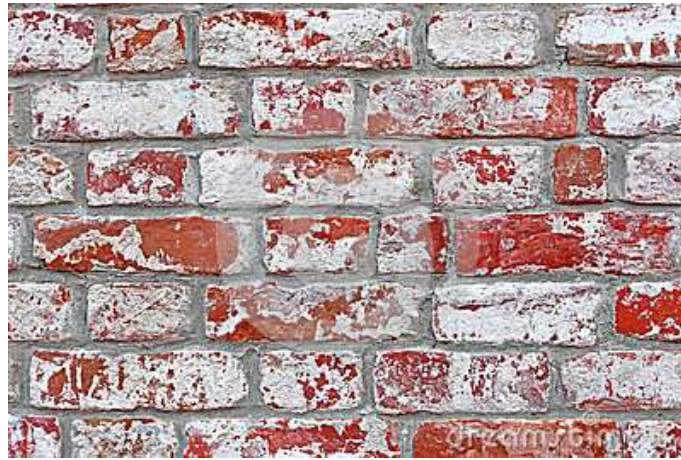
Figura 05 - Eflorescência na parede
