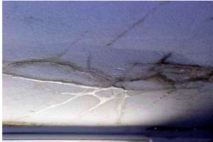
Figura 04 - Mofo no teto
