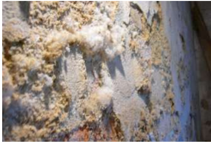
Figura 06 - Criptoflorescência na parede.
