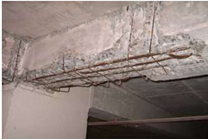
Figura 01 - Corrosão da Viga
