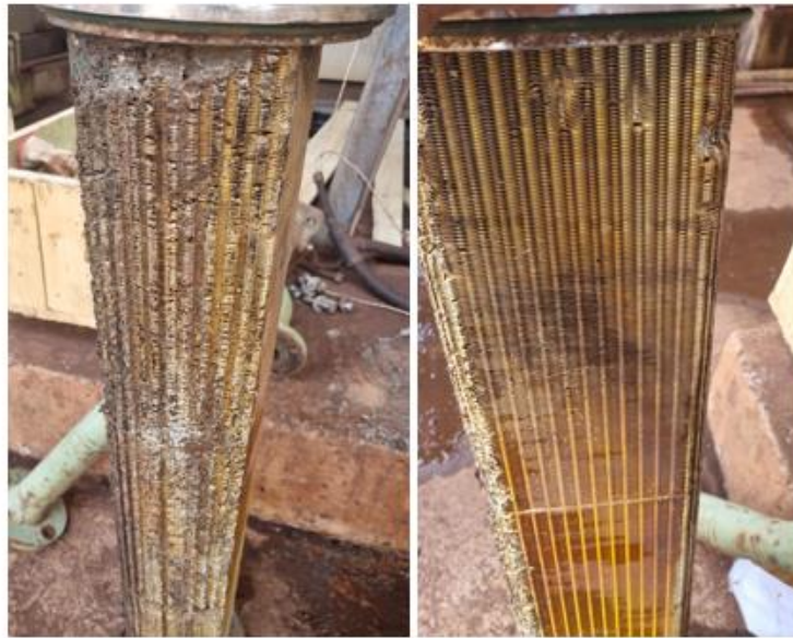
Figura 10: Realizado limpeza no trocador de calor do secador.
