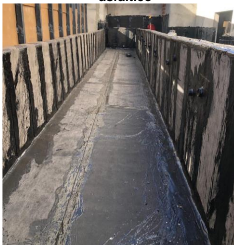
Figura 32 - Piscina após banho asfáltico
