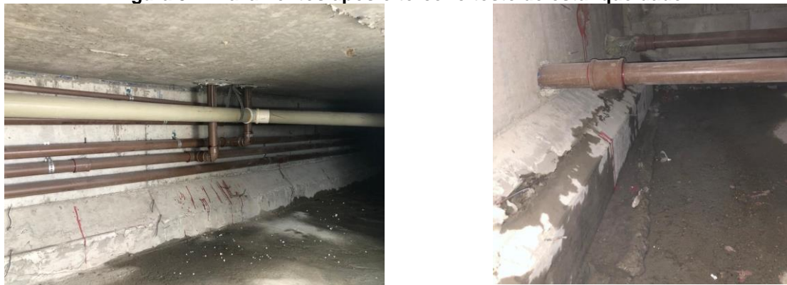
Figura 31 - Vazamentos após o terceiro teste de estanqueidade
