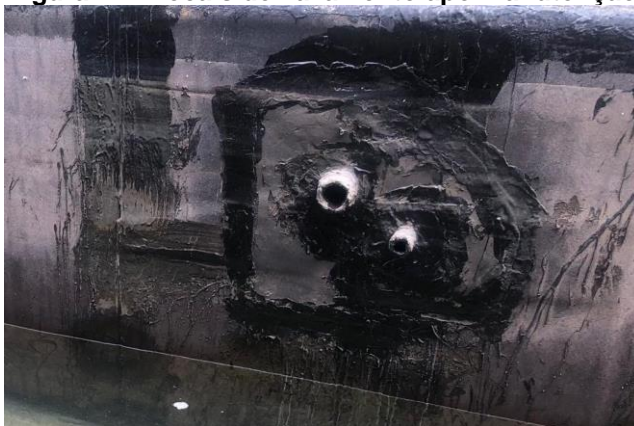
Figura 27 - Locais de vazamento após manutenção
