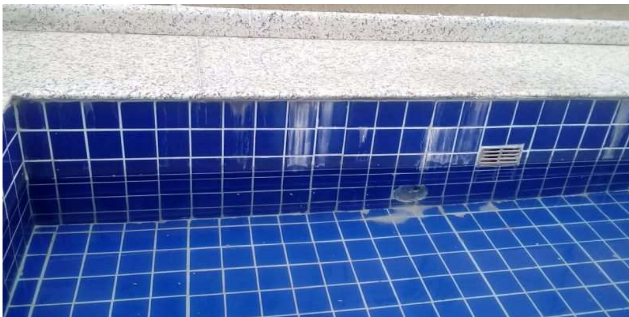
Figura 05 – Piscina com sinais de eflorescência
