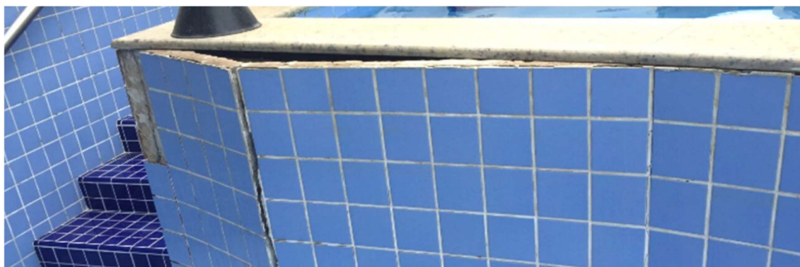
Figura 07 – Exemplo de Deslocamento de revestimento
