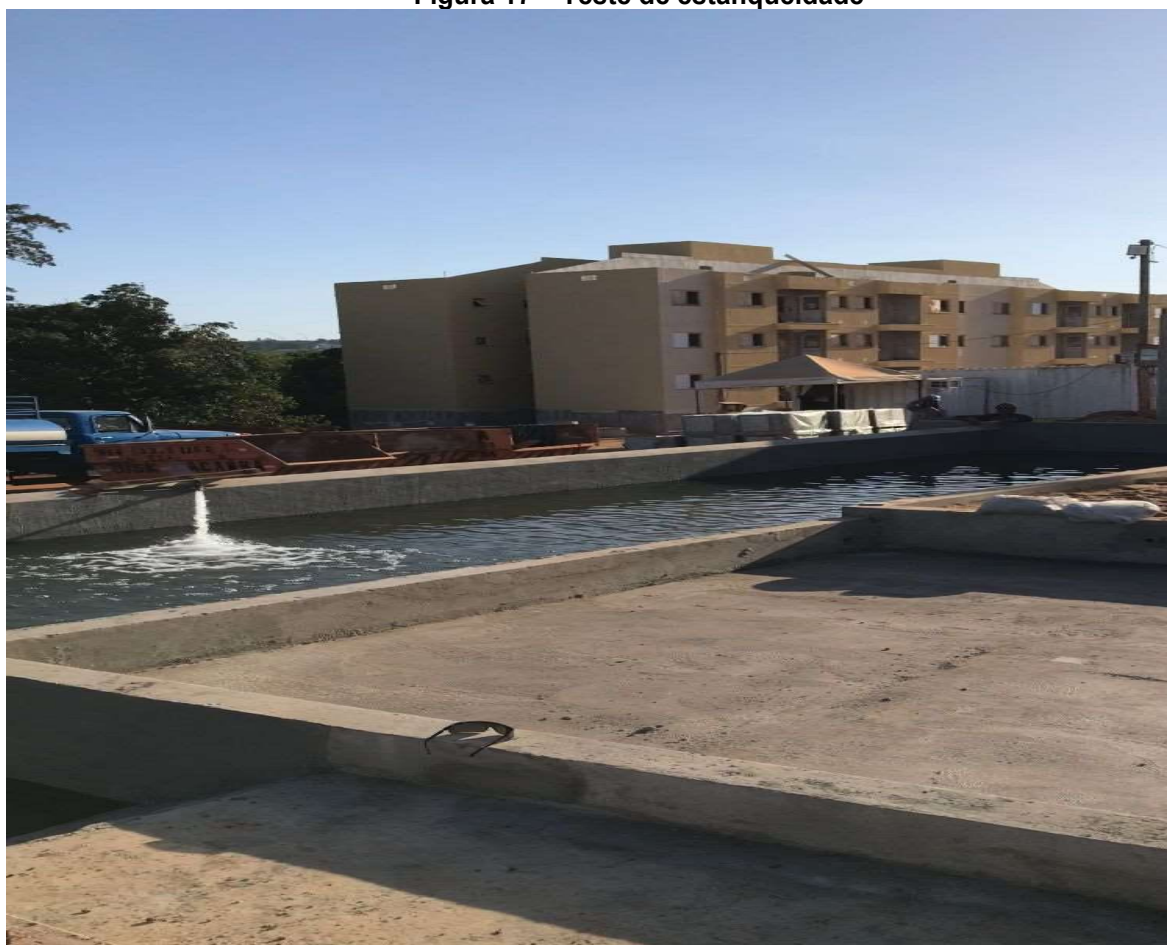
Figura 17 – Teste de estanqueidade
