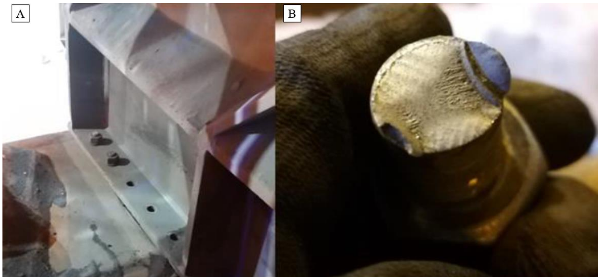
Figura 8 – A - Local de fixação da viga com a estrutura do prédio com ausência dos parafusos e dois parafusos rompidos; B - Superfície de um dos parafusos encontrado no local no dia do incidente
