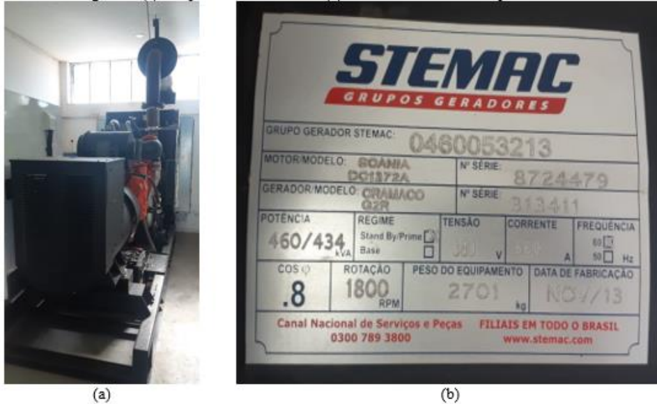
Figura 5. (a) Grupo Motor Gerador (b) Dados de Placa do Grupo Gerador
