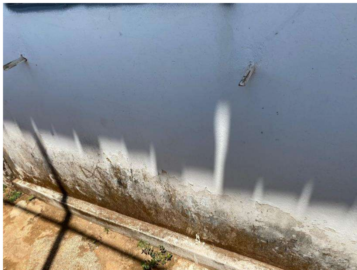
Figura 23 - Mofo localizado em uma das paredes externas.
