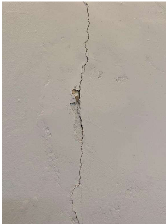
Figura 13 – Possível fissura localizada em uma das paredes do Colégio.
