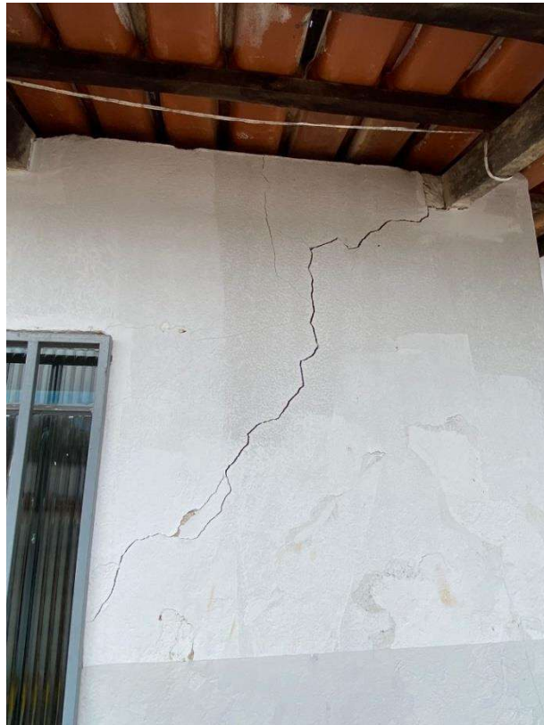
Figura 15 - Possível fissura causada por atuação de carga.
