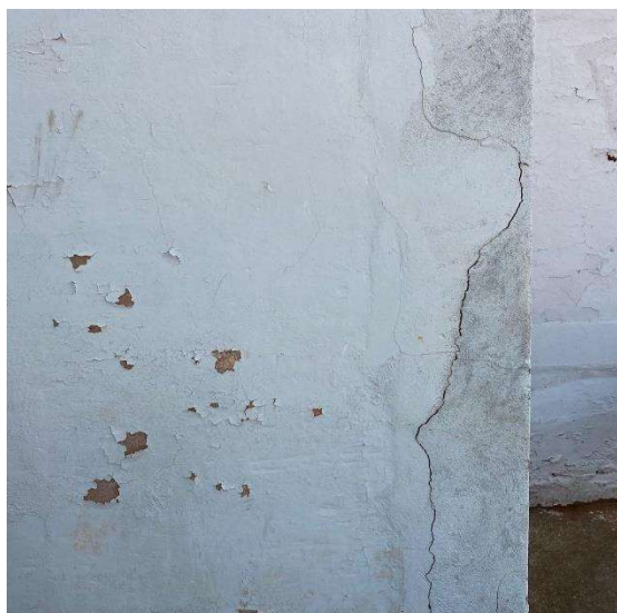
Figura 14 - Possível fissura exposta as variações climáticas.
