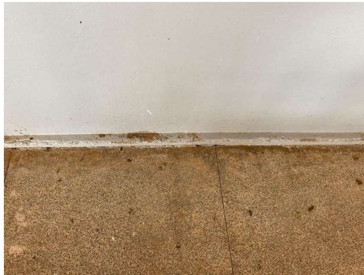
Figura 18 - Descascamento na pintura.
