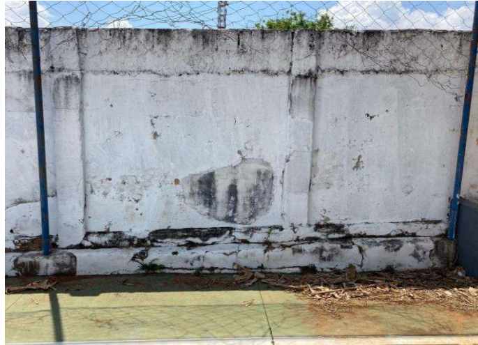
Figura 22 - Mofo localizado no muro da quadra de esportes.
