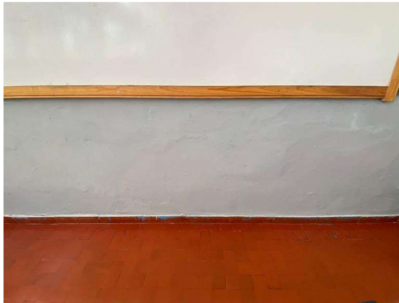
Figura 17 - Bolhas em uma das paredes internas do Colégio Estadual Salim Afiune.
