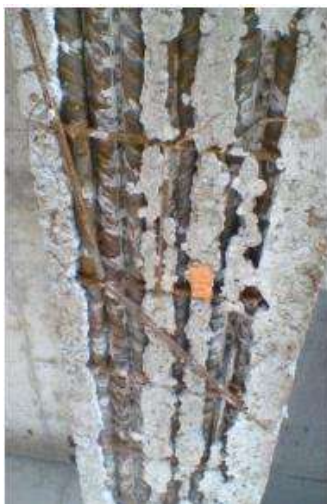
Figura 9 - Armadura exposta ao meio ambiente.
