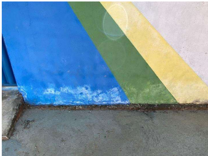
Figura 21 – Possível eflorêscencia localizada na escola.
