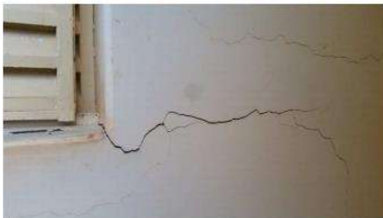
Figura 8 - Fissura canto da janela.
