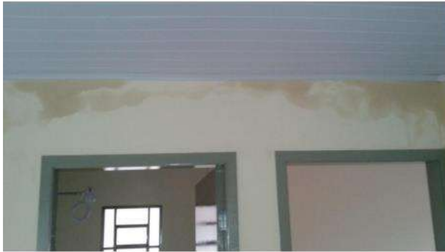
Figura 6 - Manchas por infiltrações.
