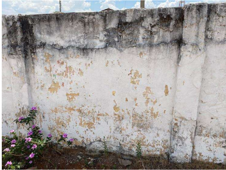
Figura 19 - Descascamento na pintura do muro.
