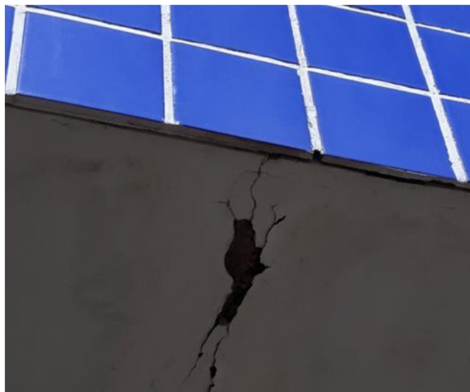
Figura 26 - Reboco e revestimentos soltos
