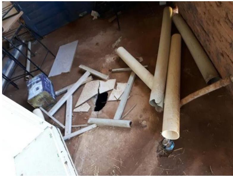
Figura 20 - Fossa no depósito nos fundos da escola
