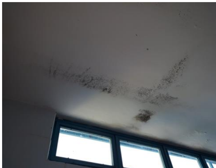
Figura 33 - Ocorrência pela infiltração 4
