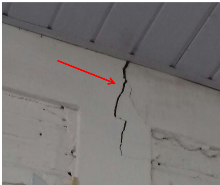
Figura 18 - Brecha no pilar da sala de aula
