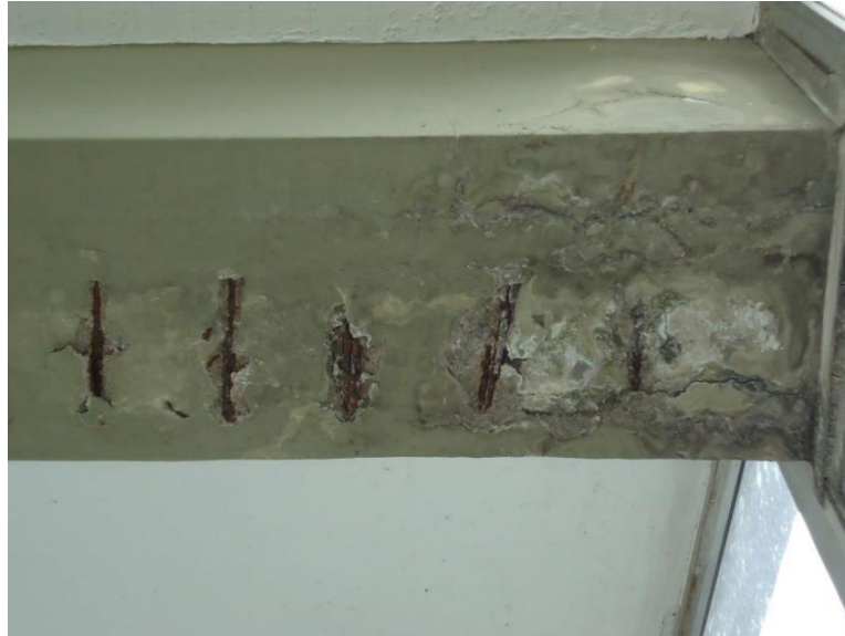
Figura 4 - Corrosão da armadura
