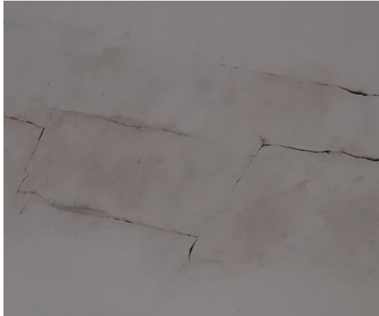
Figura 27 - Infiltrações na laje
