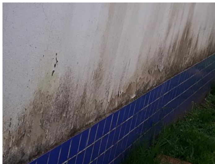
Figura 30 - Ocorrência pela infiltração 1
