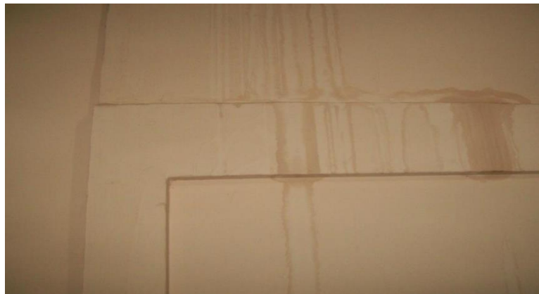
Figura 6 - Presença de goteiras em laje de forro
