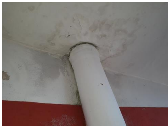
Figura 31 - Ocorrência pela infiltração 2
