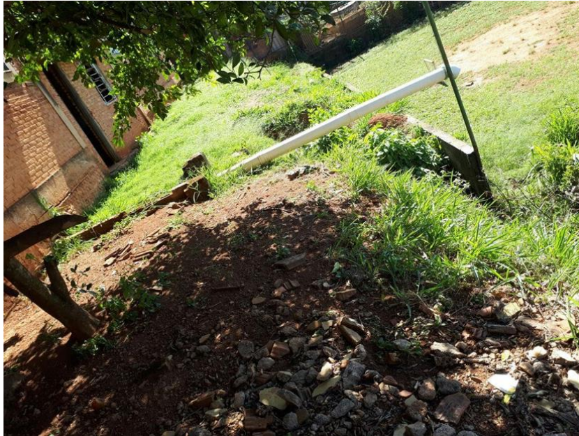
Figura 24 - Muro de arrimo e desnível do terreno frente a fossa da escola
