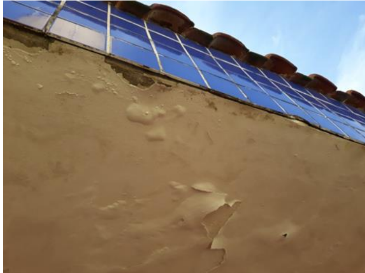
Figura 32 - Ocorrência pela infiltração 3
