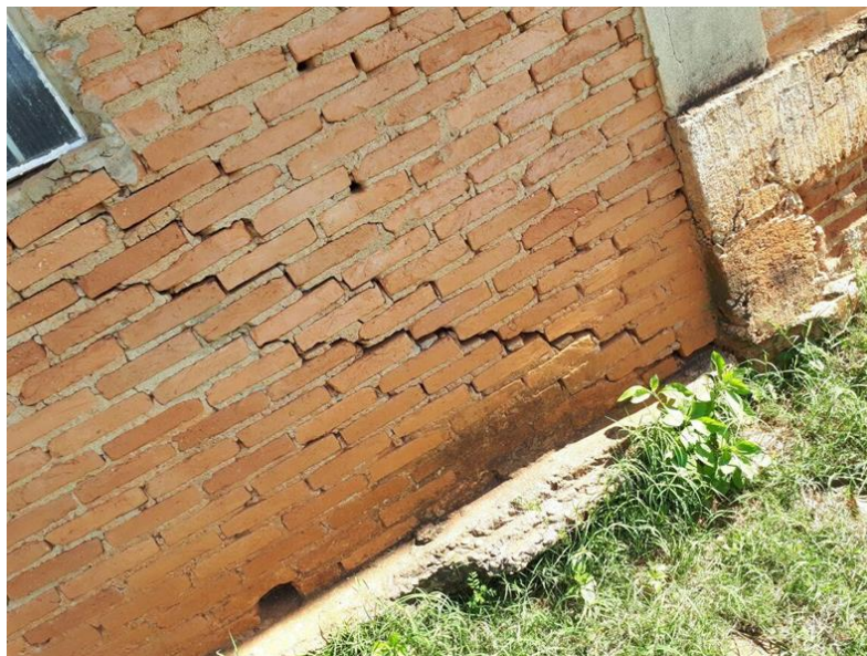
Figura 21 - Fenda na sala de depósito que abriga a fossa em questão
