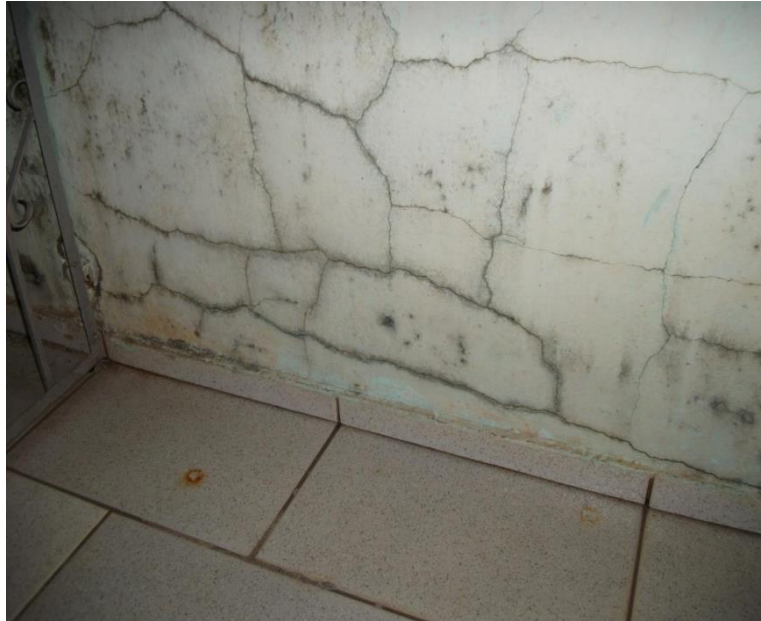
Figura 5 - Fissuras, manchas e mofos em parede externa coberta
