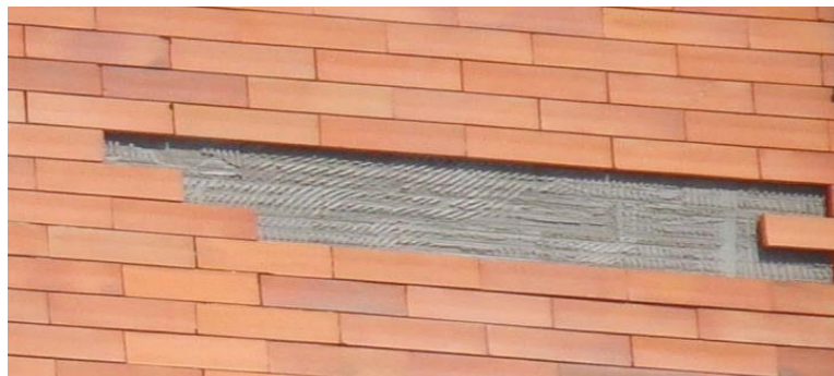
Figura 7 - Destacamento da cerâmica
