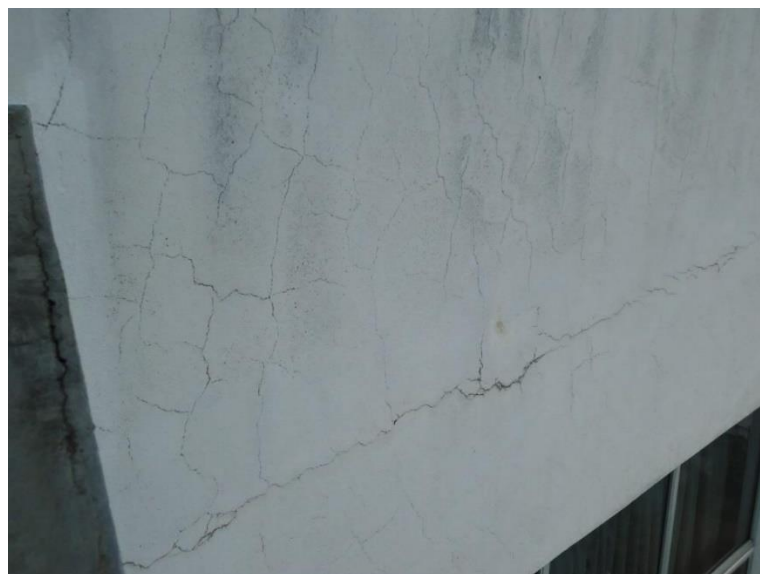
Figura 8 - Fissuras no revestimento externo de fachada
