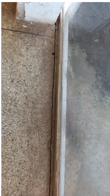
Figura 23 – Trinca no piso de granitina
