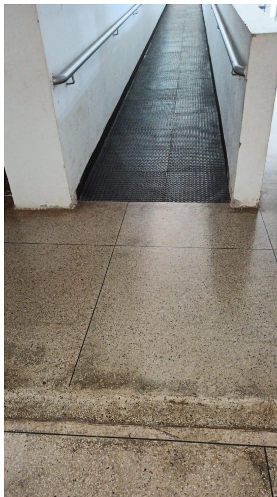
Figura 26 – Trinca no piso de granitina
