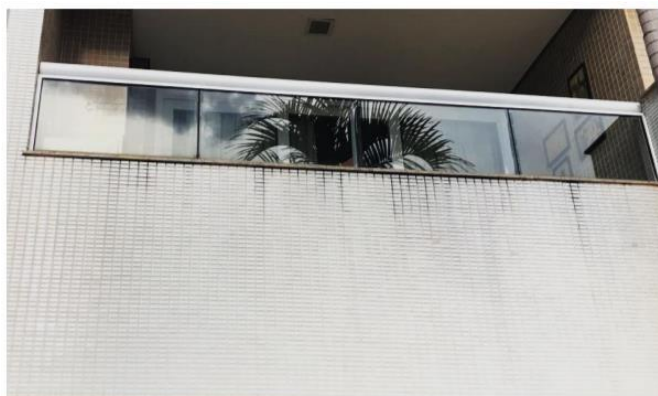
Figura 14 - Manchas de bolor em um revestimento de fachada
