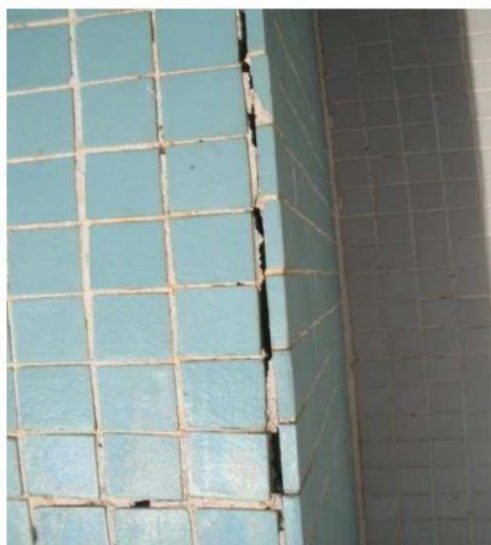
Figura 15 - Deterioração das juntas do revestimento
