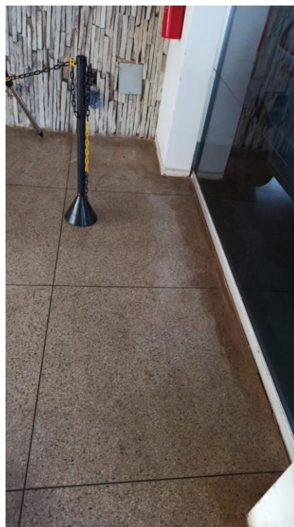
Figura 24 – Trinca no piso de granitina
