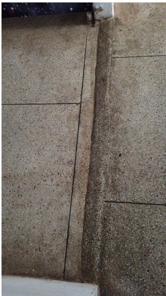
Figura 25 – Trinca no piso de granitina
