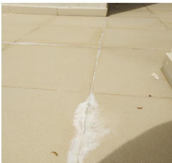
Figura 13 - Eflorescência em revestimento
