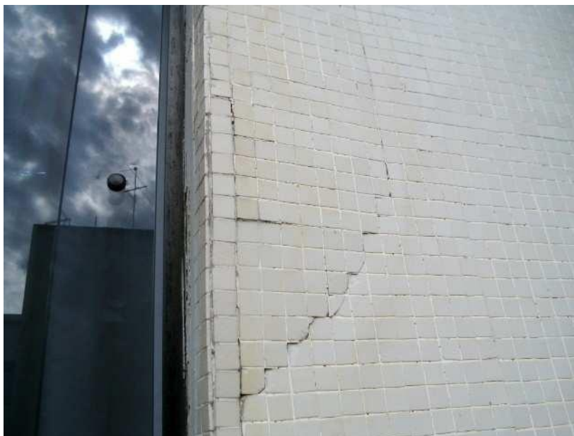
Figura 11 - Perda de aderência de revestimento
