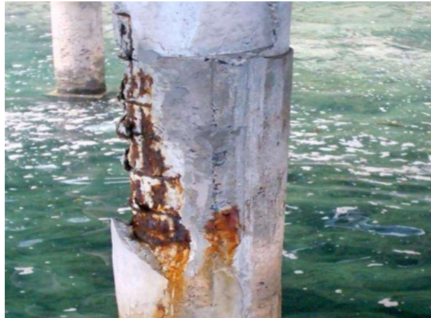
Figura 09 – Desagregação no pilar de uma ponte
