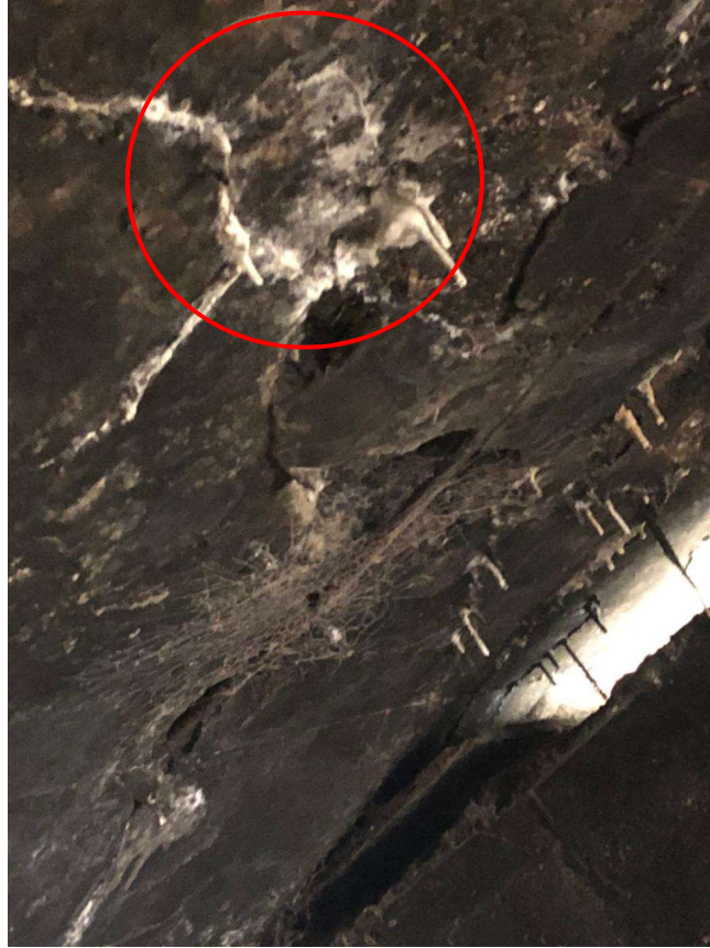
Figura 19 – Eflorescência crítica na Ponte sobre o Rio das Antas
