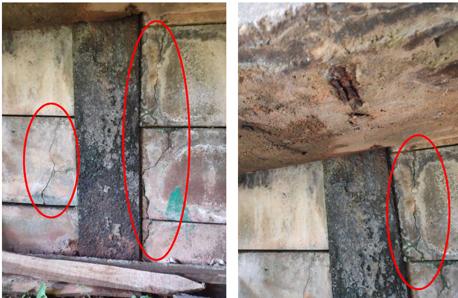
Figura 16 - Fissuras na Ponte sobre o Rio das Antas
