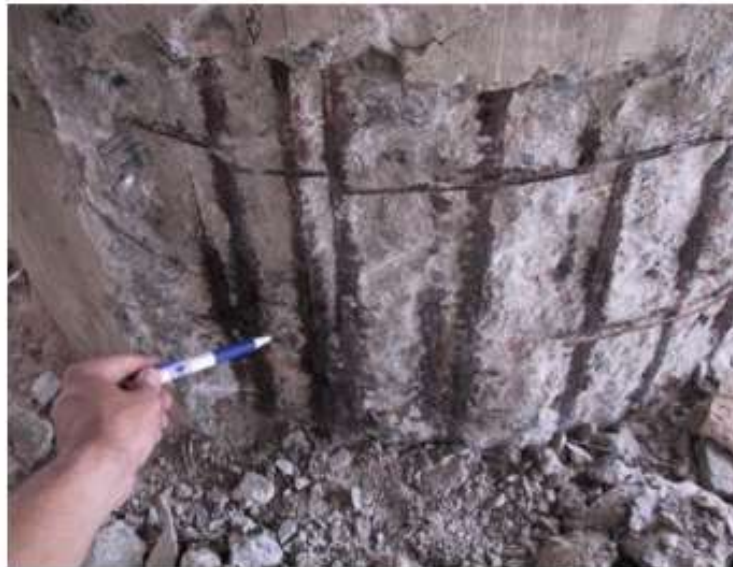
Figura 08 – Corrosão em estrutura de concreto armado
