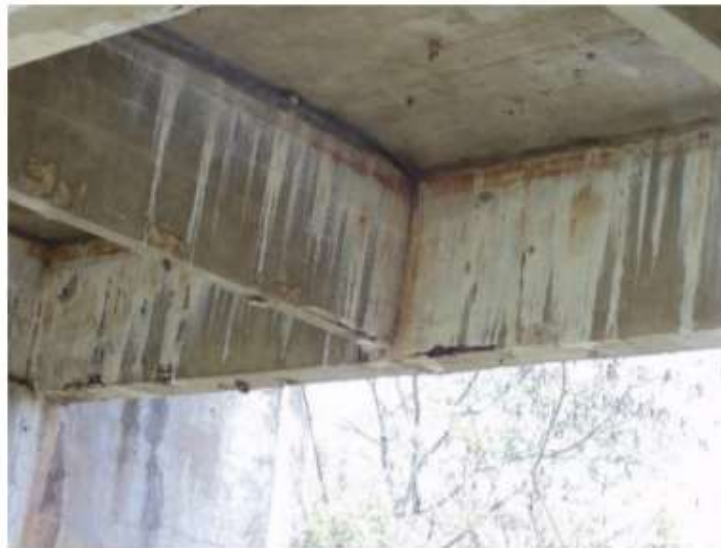
Figura 12 – Manifestação de eflorescência em estrutura de concreto
