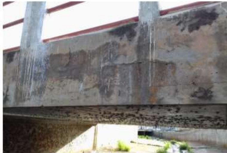
Figura 13 – Manifestação de fissuração em estrutura de concreto
