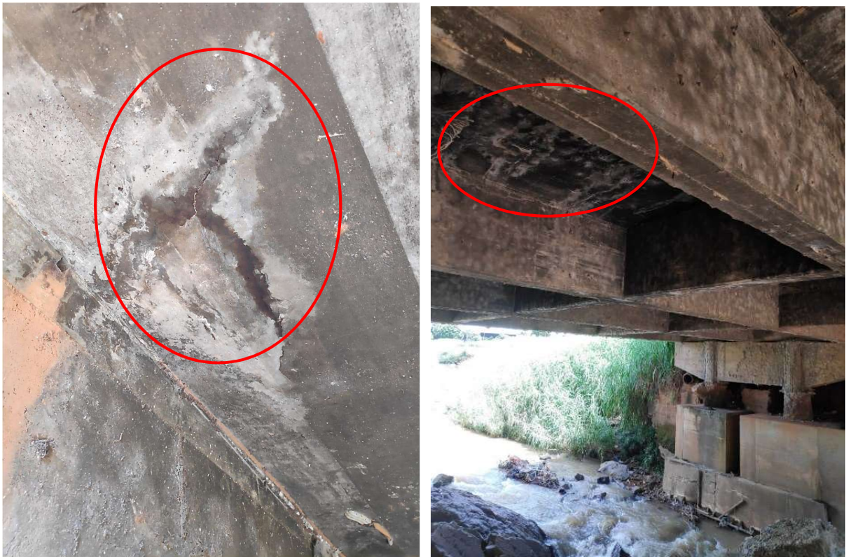
Figura 18 – Eflorescências na Ponte sobre o Rio das Antas
