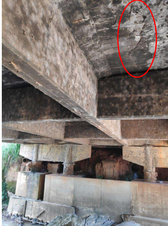
Figura 17 - Fissuras na superestrutura da Ponte sobre o Rio das Antas
