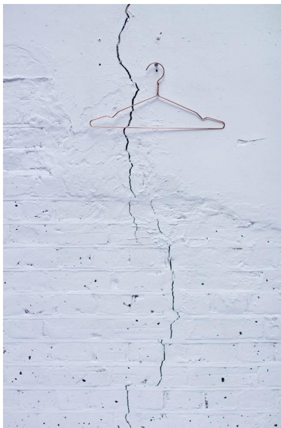
Figura 2 – Fissuração por Variação Térmica
