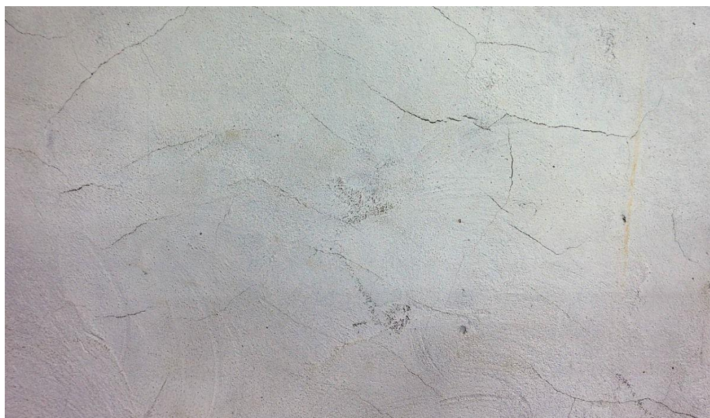
Figura 3 – Retração do Concreto
