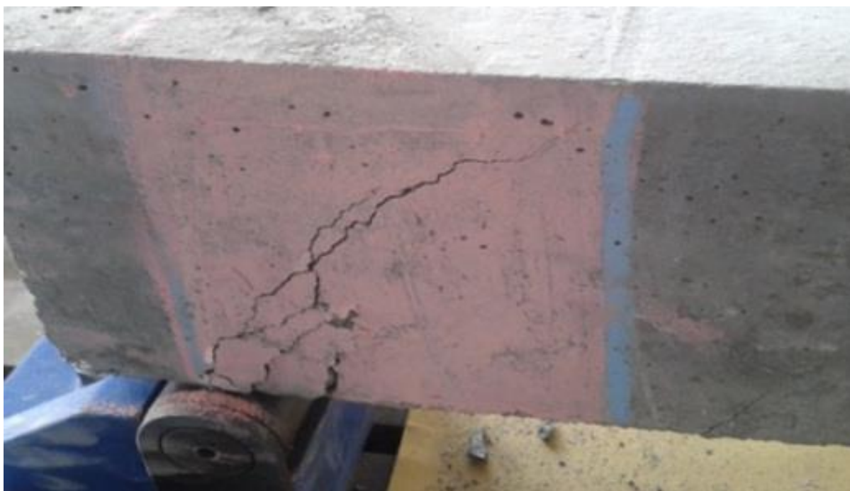
Figura 8 – Fissura inclinada na região do apoio
