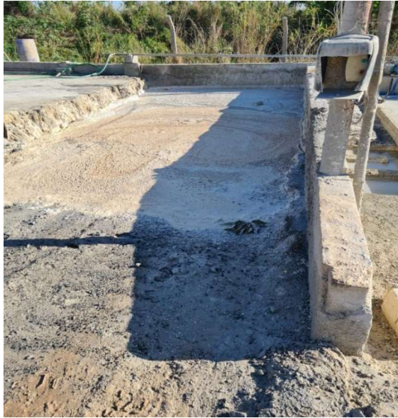
Figura 10 - Tanque de captação de água após lavagem de caminhões betoneira
