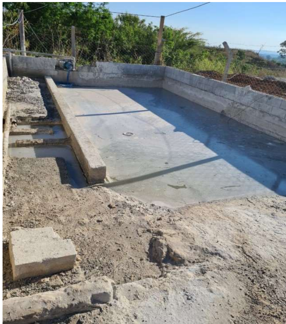
Figura 11 - Tanque de armazenamento de água após filtragem
