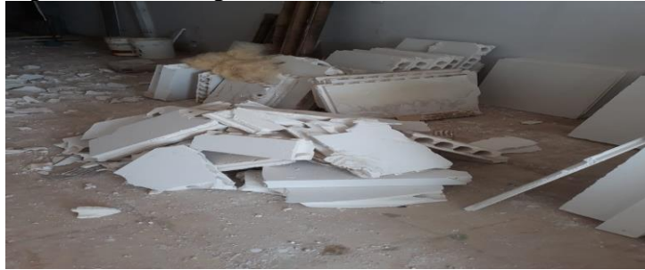
Figura 7- Resíduos gerados de sobras e material danificado
