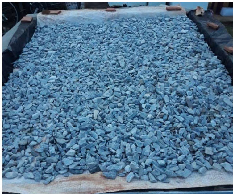
Figura 3.17 – Sistema de drenagem.
