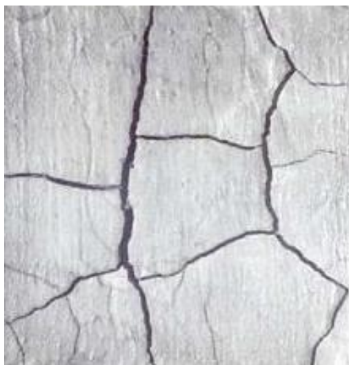
Figura 4 – Fissuras causadas no concreto devido a temperatura.
