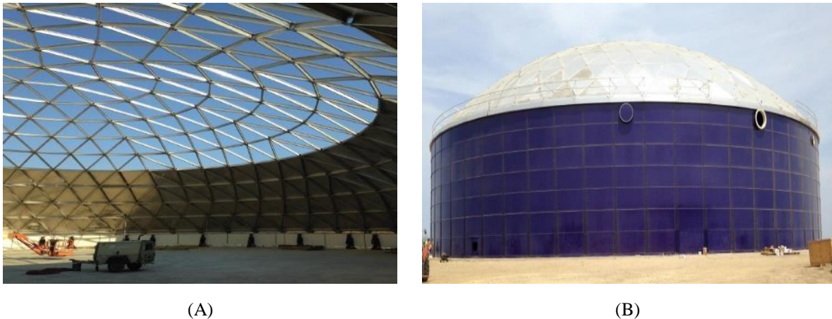
Figura 3 – Reservatório de água potável em aço vitrificado sendo construído (A) e reservatório concluído (B).
