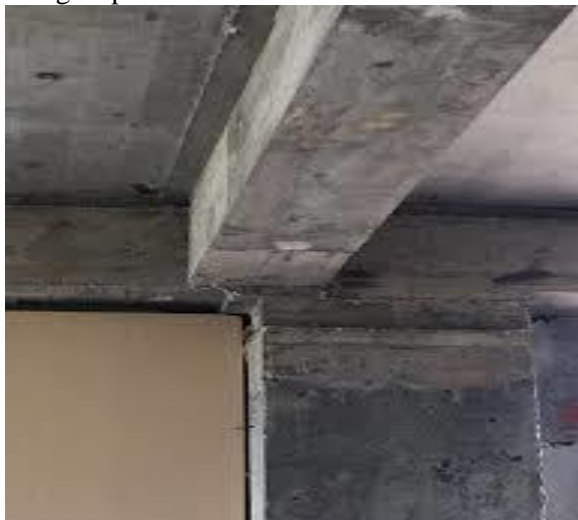
Figura 08 – Desalinhamento viga e pilar.
