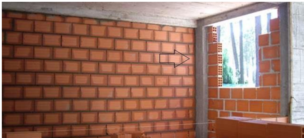
Figura 02 – Pilar sobressaindo da alvenaria.
