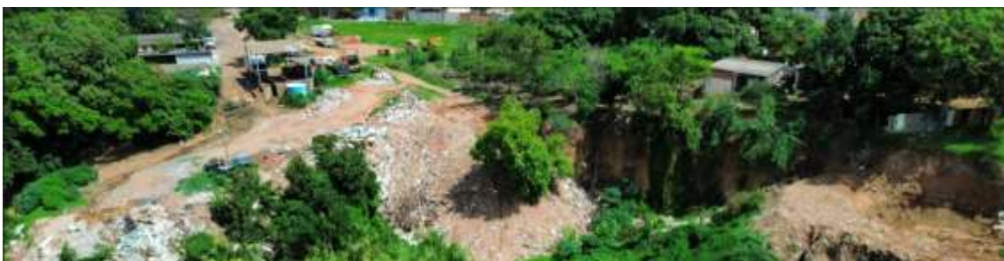
FIGURA 7: Erosão situada entre às Escolas Irenize Laurindo de Souza e Laura Barbosa Coelho com grande proximidade das residências.
