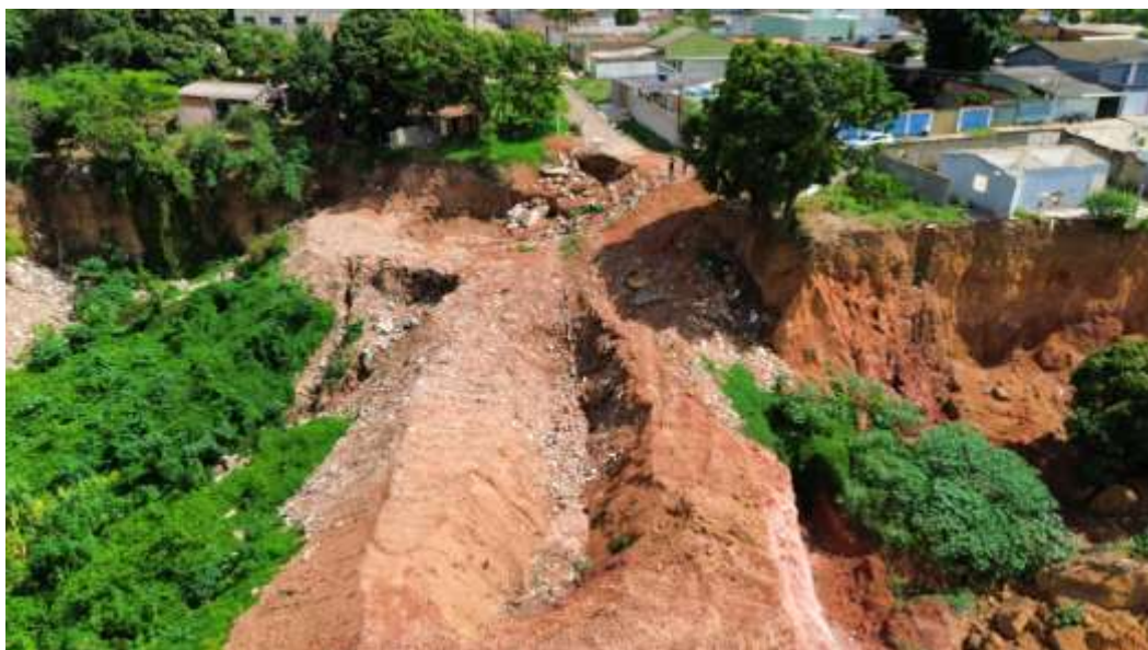
FIGURA 4: Erosão situada ao final da rua N° 28, Setor 13 de Maio
