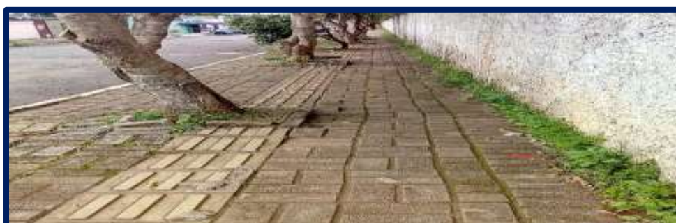
Figura 12: Calçada com sinalização tátil direcional inadequada.
