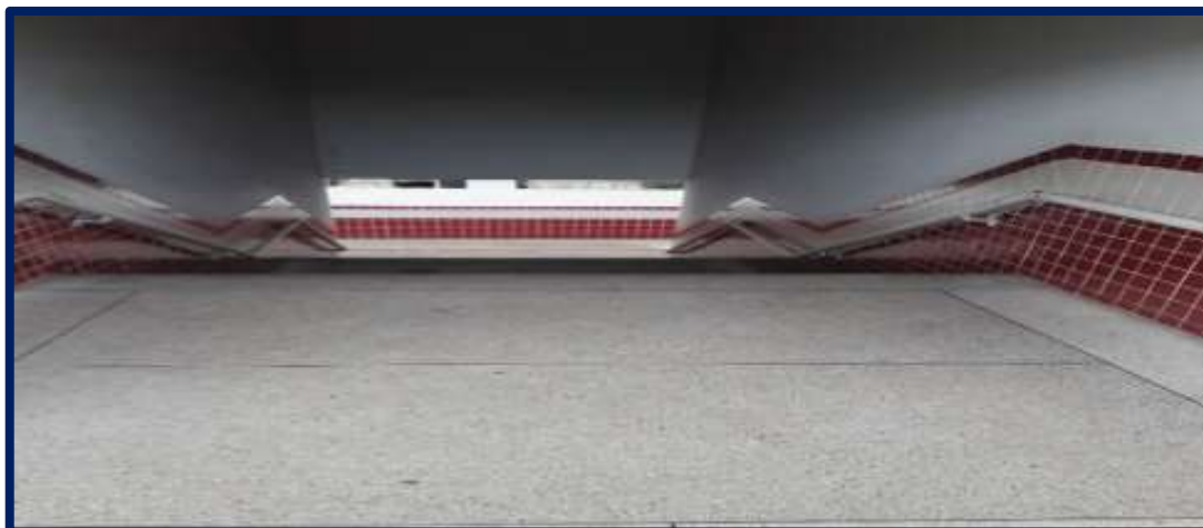
Figura 28: Escadas sem sinalização no início e no fim.
