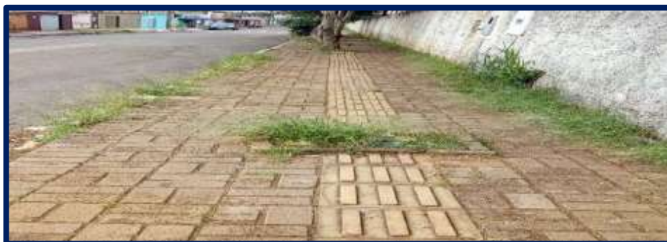
Figura 10: Calçada com obstáculo e sinalização inadequada E.
